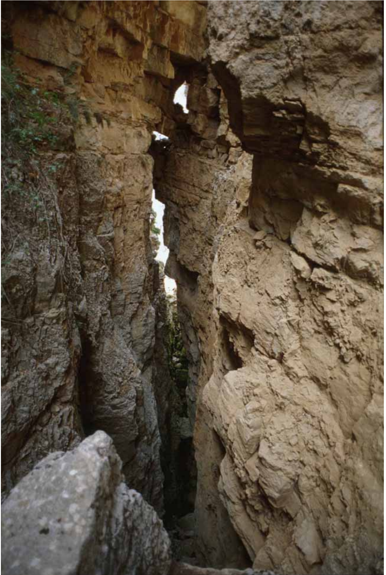
Aspecto del interior de una grieta donde se aprecia lo inestable de las paredes
